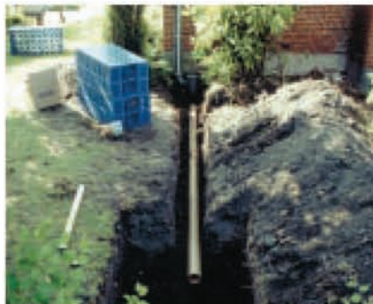
1. A munkákat a munkagödör kiásásával kezdjük, amely 40 centiméterrel szélesebb legyen mint a lerakandó szikkasztó mező mérete. A tömörített tükörre 5-10 cm vastag homokos-kavics réteg kerül.
